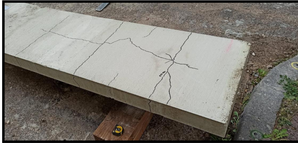
(a) Fissures de fendage sur la face supérieure de la dalle de béton du spécimen 'PM-CP'.
