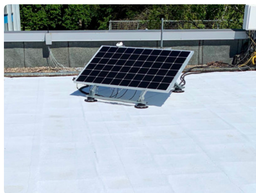
(b) Photographie du panneau photovoltaïque installé sur la parcelle Coolroof
