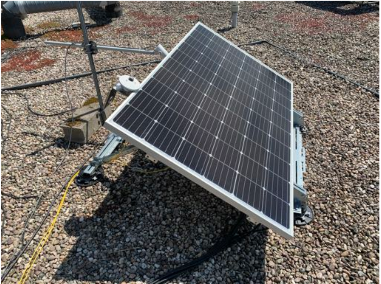
FIG. 4.4. : Panneau photovoltaïque de 310 W disposé sur la parcelle Gravier de la plateforme expérimentale du Cerema (Nancy). Le pyranomètre est dans le plan d'incidence du panneau et un pyromètre mesure la température de surface du sol sous le panneau. Les autres capteurs ne sont pas visibles sur la figure, notamment les capteurs de température du panneau en face arrière.
