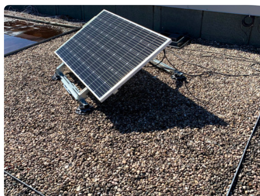
(d) Photographie du panneau photovoltaïque installé sur la parcelle Gravier
