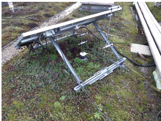
(a) Photographie de la végétation sous le panneau photovoltaïque Témoin en saison hivernale.
