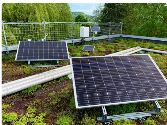
(a) Photographie du panneau photovoltaïque installé sur la parcelle végétalisée Argile Expansée
