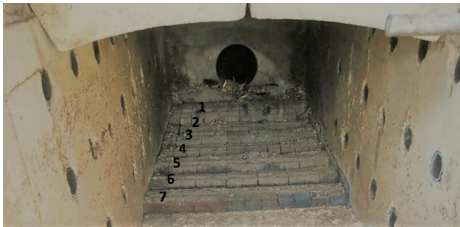
Figure 25 : Grilles de la chaudière
