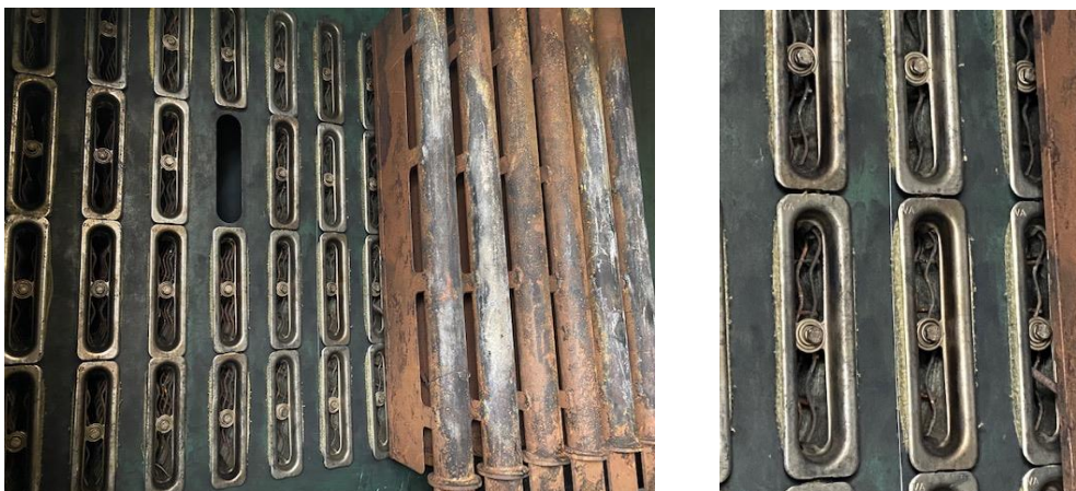
Figure 30 : Photos de filtres à manches horizontales (zone 7)
