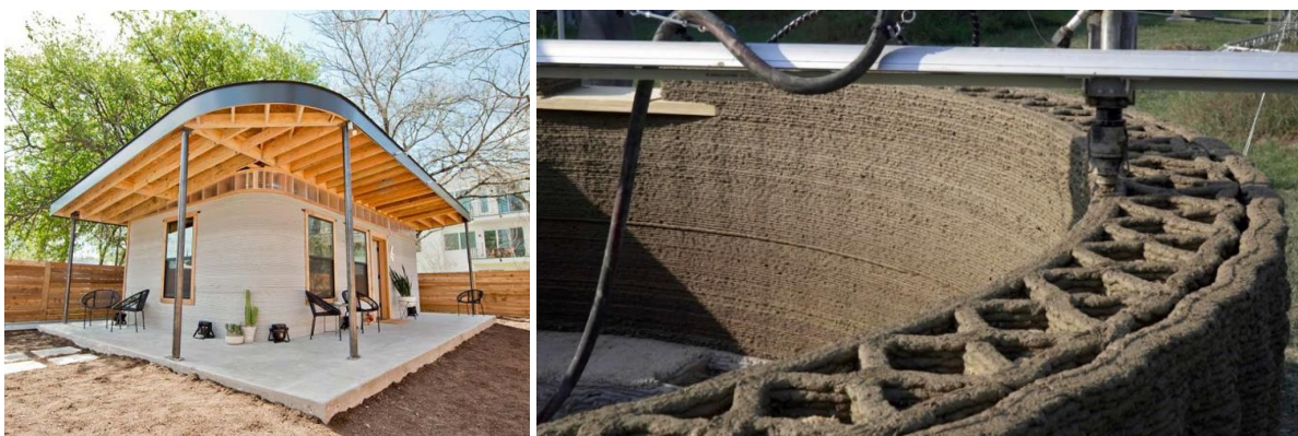
Figure 9. Complexité géométrique des projets réalisés par des procédés d'extrusion de matériaux : le projet The Chicon House réalisé par ICON aux Etats-Unis présente des parois courbes (à gauche) ; le projet GAIA réalisé par WASP en Italie présente des parois dont la structure est alvéolaire (à droite). Disponibles à l'adresse : https://urlz.fr/nFqc et à l'adresse : https://urlz.fr/nFqf [Consultées le 13 septembre 2023]
