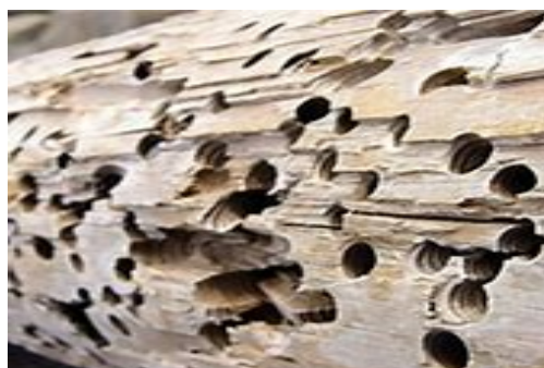
Figure 14 : bois altéré par les tarets.
